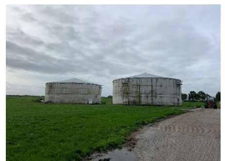
スラリータンク
